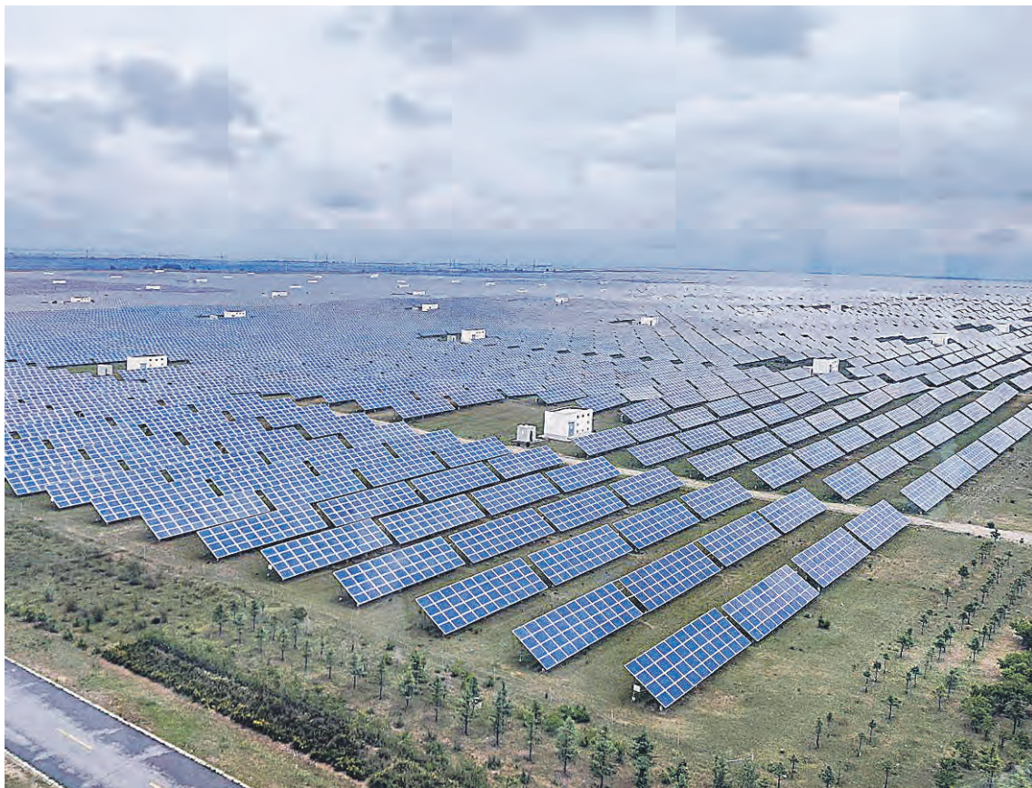
EGUZKI PANELAK. Zentral fotovoltaiako bat Hainanen, Txinan. ALVARO ALFARO / EFE
